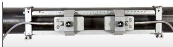
Измерение датчиками, смонтированными на портативном Variofix VP
