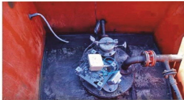
ИЗМЕРЕНИЕ МАССЫ ЖИДКОСТИ В ЗАГЛУБЛЕННОМ РЕЗЕРВУАРЕ
